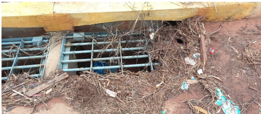
Figura 2 – Bocas de Lobo pintadas e acúmulo de dejetos carregados com água
