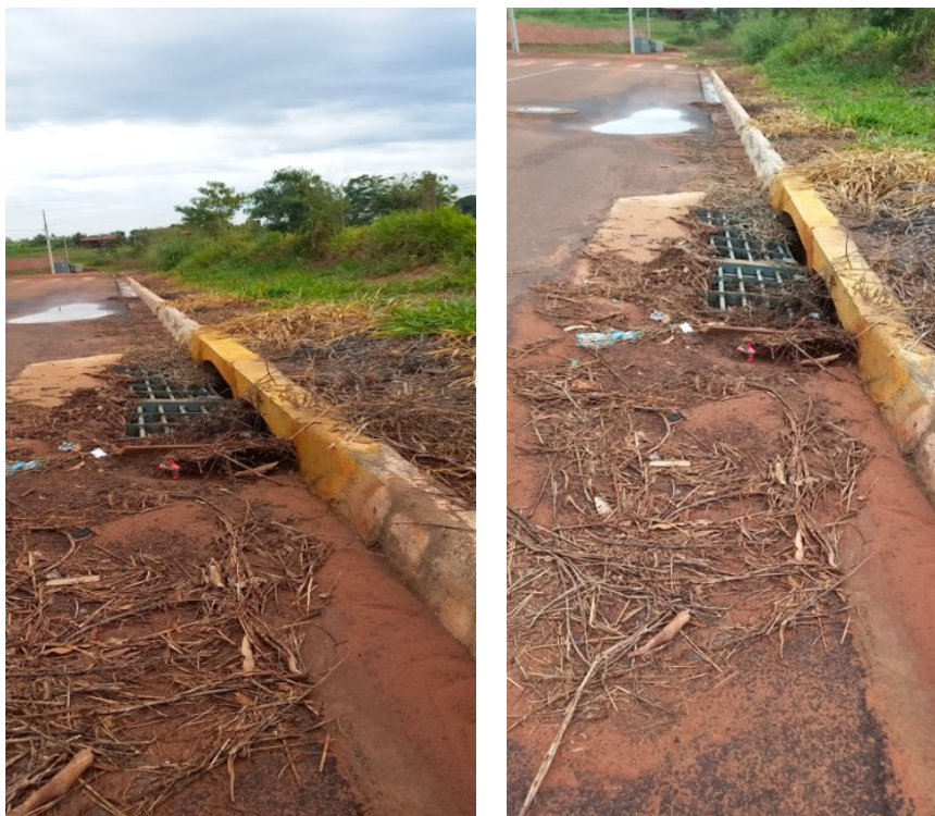
Figura 3 – Dejetos acumulados na boca de lobo
